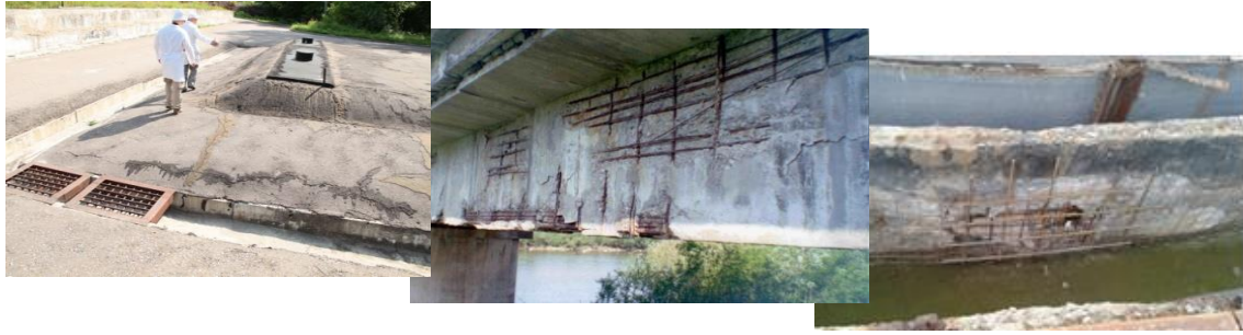
Рис. 6.2 Проблеми корозії та руйнування бетону
